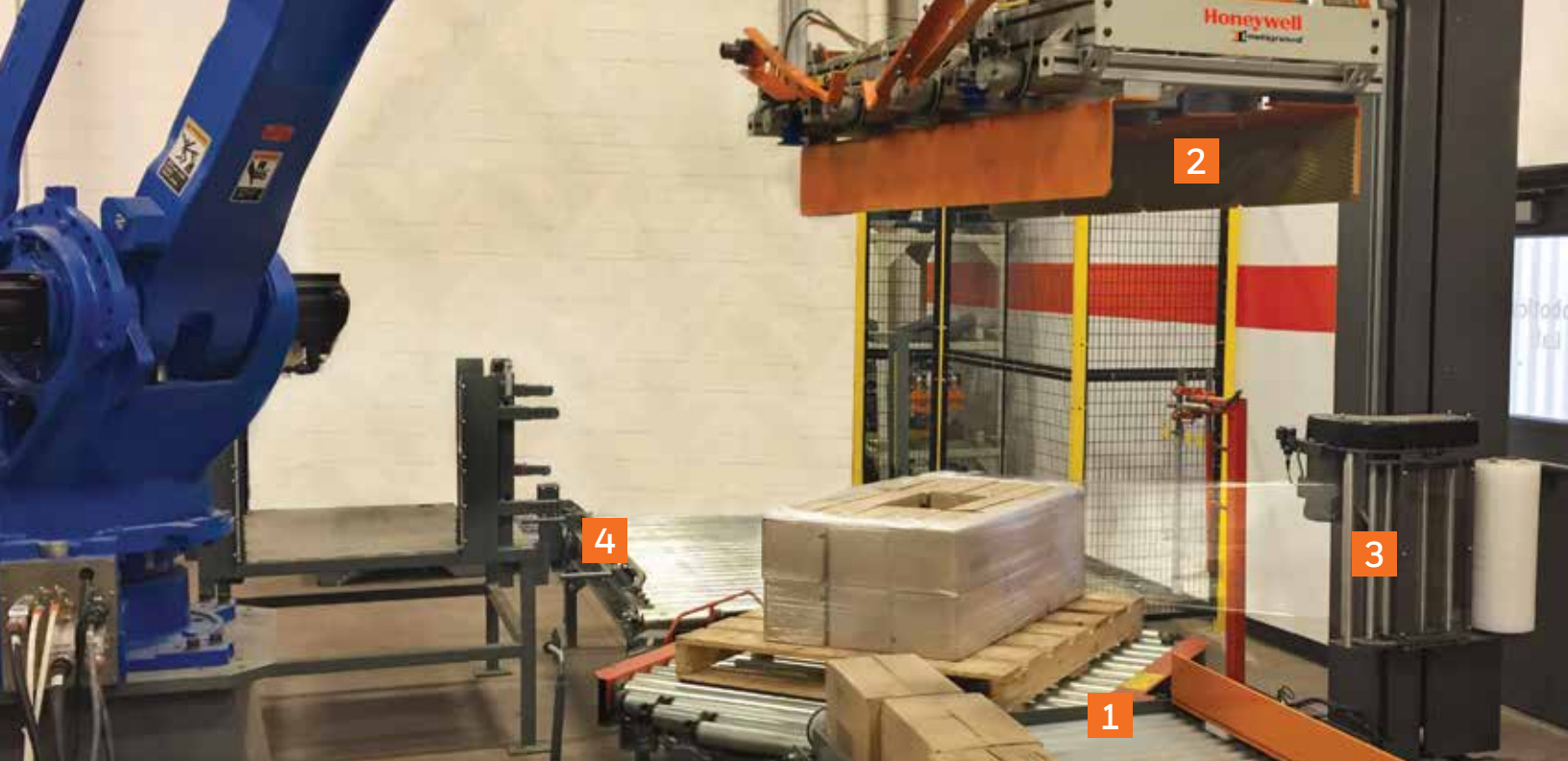
1. Convoyeur d'alimentation et palettisation des charges 2. Outillage robotique Alvey 3. Emballeuse 4. Manutention de palettes et de feuilles
